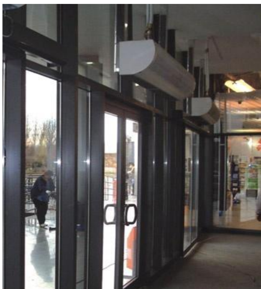
Рисунок 31 – Горизонтальные тепловые завесы над входными дверями
