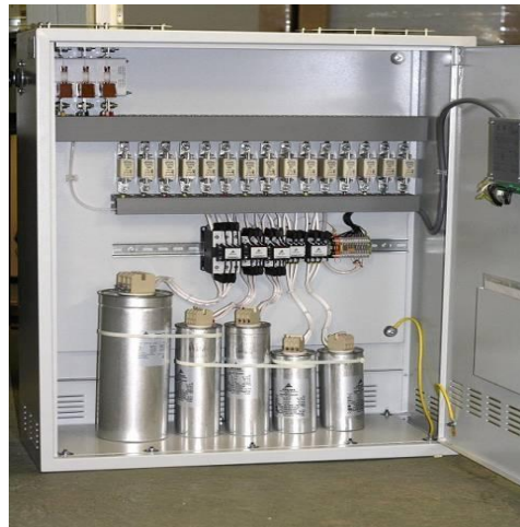
Рисунок 3 – Компенсатор реактивной мощности с конденсаторными батареями
