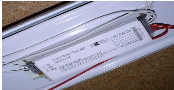
Рисунок 4 – Электронный балласт (дроссель) в светильнике с трубчатыми люминесцентными лампами
