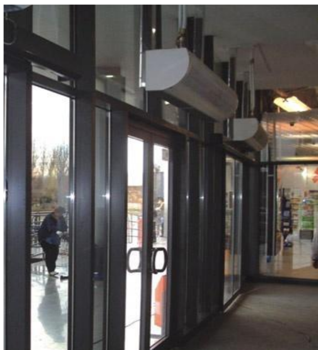
Рисунок 26 – Горизонтальные тепловые завесы над входными дверями
