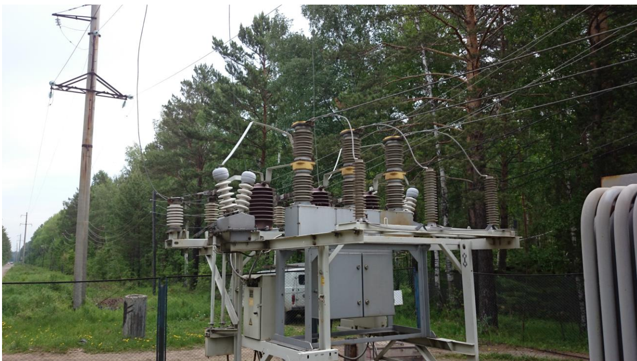
Рисунок 9 – Воздушная линия, линейный разъединитель, вакуумный выключатель, измерительные трансформаторы тока и напряжения, установленные на ОРУ 35 кВ
