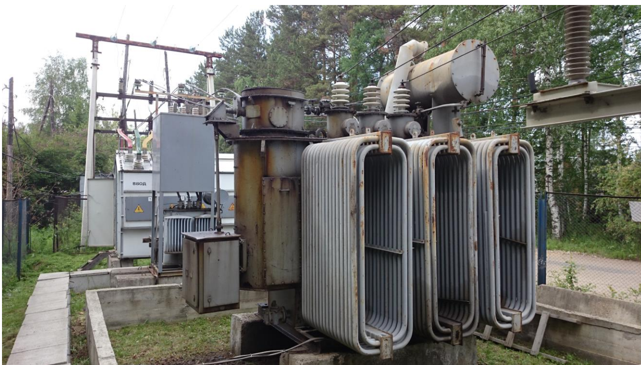
Рисунок 10 – Силовой трансформатор 35/10 кВ, трансформатор собственных нужд 10/04 кВ, КРУ 10 кВ наружной установки
