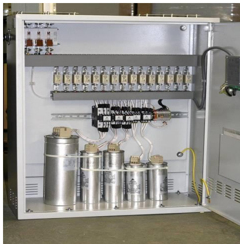
Рисунок 8 – Компенсатор реактивной мощности с конденсаторными батареями
