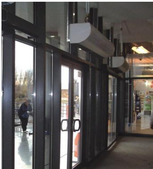
Рисунок 31 – Горизонтальные тепловые завесы над входными дверями
