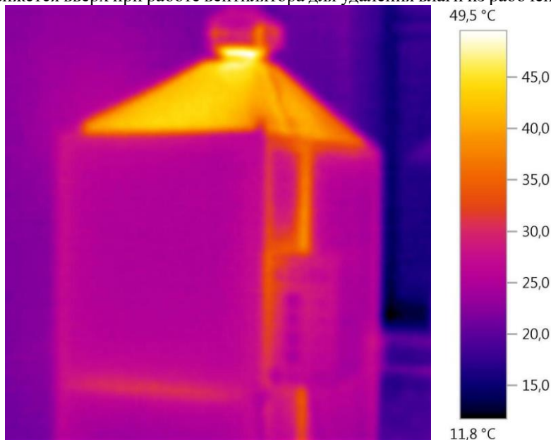
Рисунок 2 – Тепловизионное представление потерь теплоты через ограждения корпуса сушильной установки
